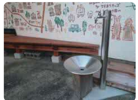
▲ぽけっとパーク内に設置した水道
